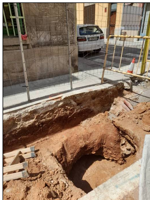
Foto 60. Tram Ventalló-Nogués. Rasa per a serveis i xarxa d'hidrants Retall UE 1013. Ubicació.
