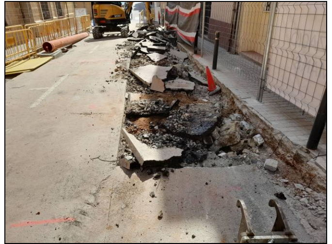
Foto 38. Tram Ventalló-Nogués. Rasa per a serveis i xarxa d'hidrants. Desmuntatge parcial de la calçada.
