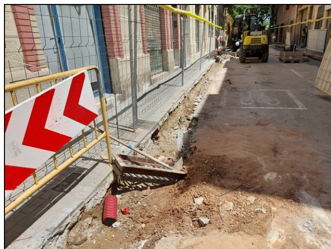
Foto 91. Tram Nogués-Sardenya. Rasa per a serveis i xarxa d'hidrants. Desmuntatge de la vorada.
