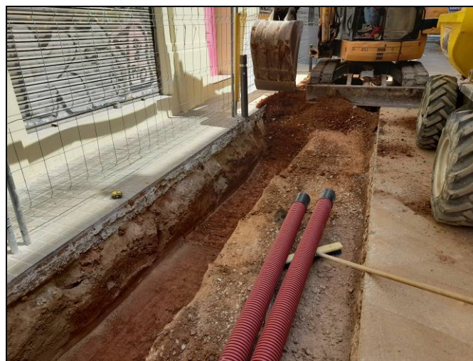
Foto 100. Tram Nogués-Sardenya. Rasa per a serveis i xarxa d'hidrants. Obertura de la rasa per a serveis.
