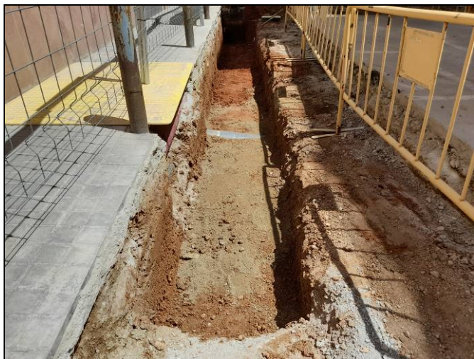
Foto 41. Tram Ventalló-Nogués. Rasa per a serveis i xarxa d'hidrants. Obertura de la rasa per a serveis.
