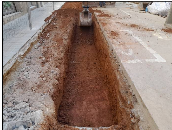
Foto 94. Tram Nogués-Sardenya. Rasa per a serveis i xarxa d'hidrants. Obertura de la rasa per la xarxa d'hidrants.
