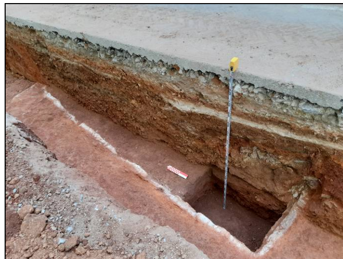
Foto 54. Tram Ventalló-Nogués. Rasa per a serveis i xarxa d'hidrants. Dipòsit UE 1010. Cala a l'interior.
