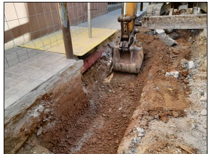
Foto 40. Tram Ventalló-Nogués. Rasa per a serveis i xarxa d'hidrants. Obertura de la rasa per a serveis.
