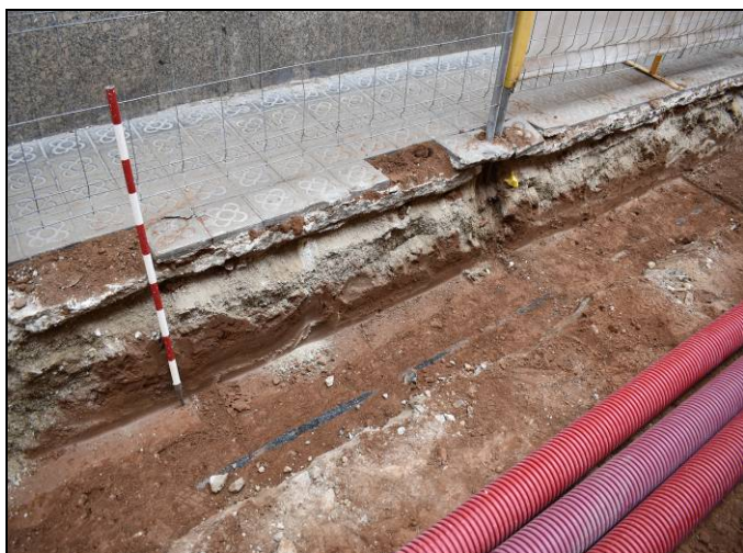
Foto 103. Tram Hipòlit Lázaro-Pau Alsina. Rasa per a serveis i xarxa d'hidrants. Obertura de la rasa per la xarxa de serveis.
